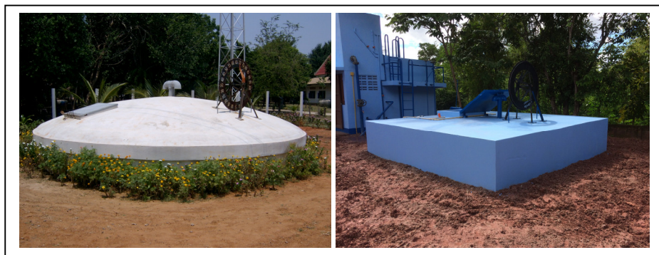
รูปที่ 37 ถังน้ำใสขนาด 100 และ 50 ลบ.ม.
