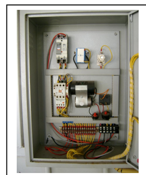
ลักษณะภายในตู้ควบคุม เครื่องสูบน้ำแบบจมน้ำ
