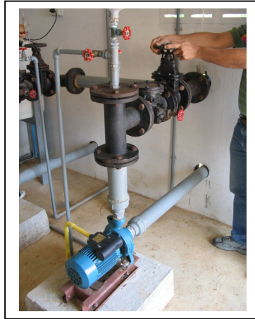
รูปที่ 57 ปิดประตูน้ำด้านท่อจ่ายน้ำของเครื่องสูบน้ำดี
