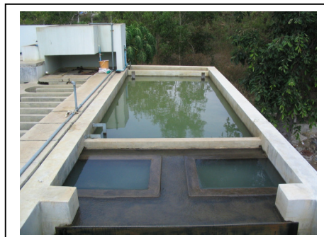
รูปที่ 30 ถังตกตะกอน
