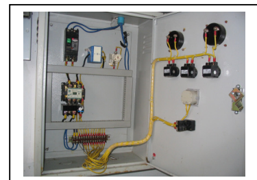
ลักษณะภายในตู้ควบคุม เครื่องสูบน้ำแบบหอยโข่ง
