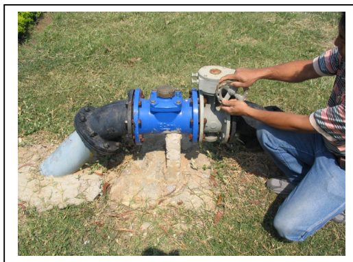
รูปที่ 59 เปิดประตูน้ำจ่ายน้ำประปา (ประตูน้ำหมายเลข 1)
