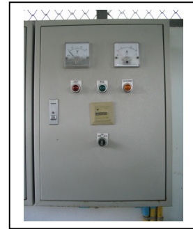
ลักษณะภายนอกตู้ควบคุม
