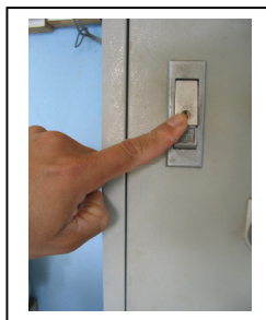
รูปที่ 17 ปุ่มปิดประตูตู้ควบคุมเครื่องสูบน้ำดิบ
