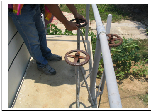
รูปที่ 55 เปิดประตูระบายน้ำทิ้งจากพื้นถังกรอง (ประตูน้ำหมายเลข 4)
